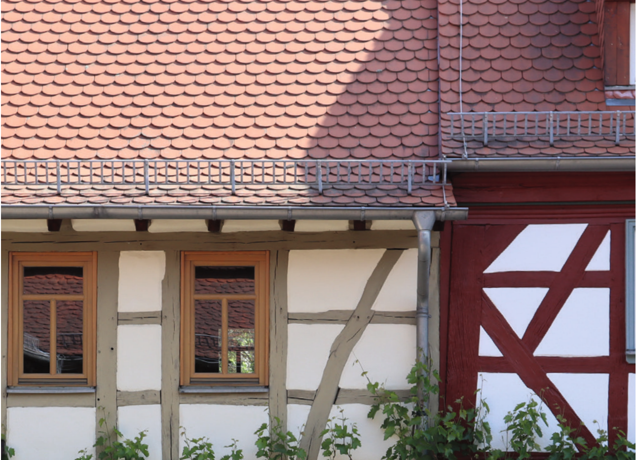
Der Dachabschluss an der Traufe ist meist mit einem Traufkasten oder einer Traufbohle ausgeführt
